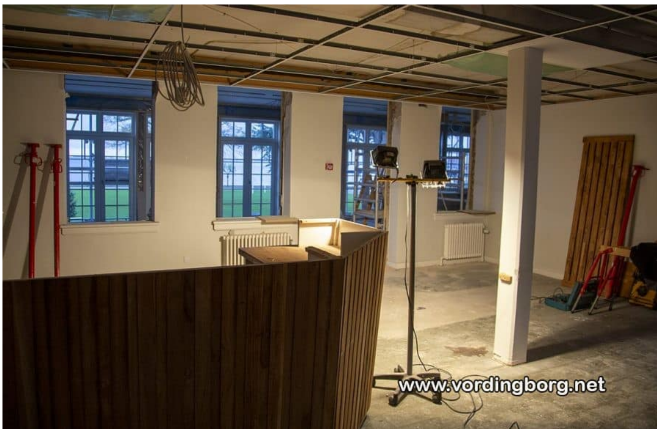
Der skal fjernes dele af den tidligere ydervæg, så der åbnes mere op til den nye tilbygning.
